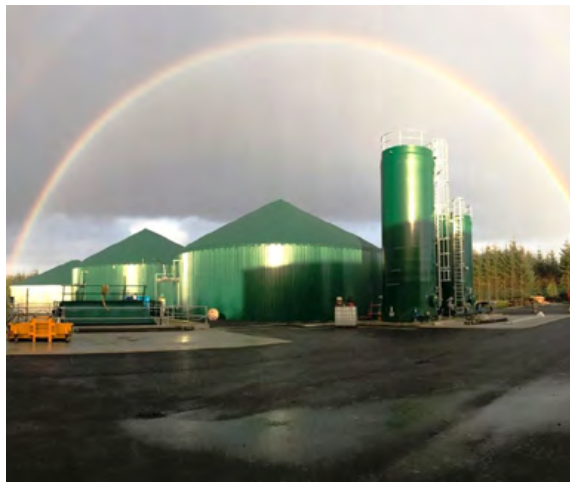
1MW Biogas Generator
